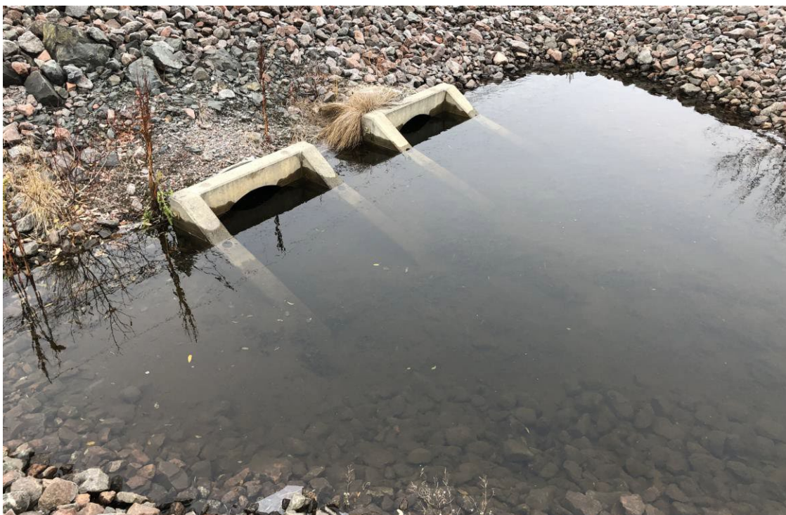
Figur 2-5. Bild av de två kulvertarna under den västra järnvägen sett från nedströmssidan tagen vid platsbesöket den 14 oktober 2021.
