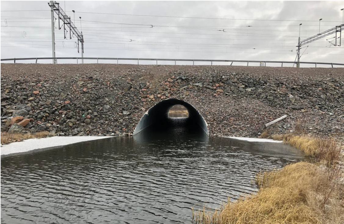
Figur 2-7. Bild av kuverten under den östra järnvägen sett från NS sidan tagen vid platsbesöket den 14 oktober 2021.
